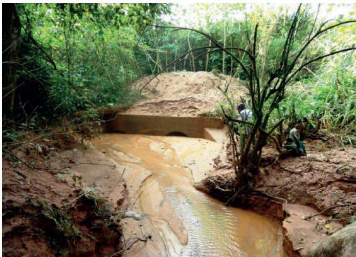
Enorme intensidade de assoreamento promovida por processos erosivos nas frentes de expansão urbana (mesma área) (foto de domínio público pelo critério de fair use ).
