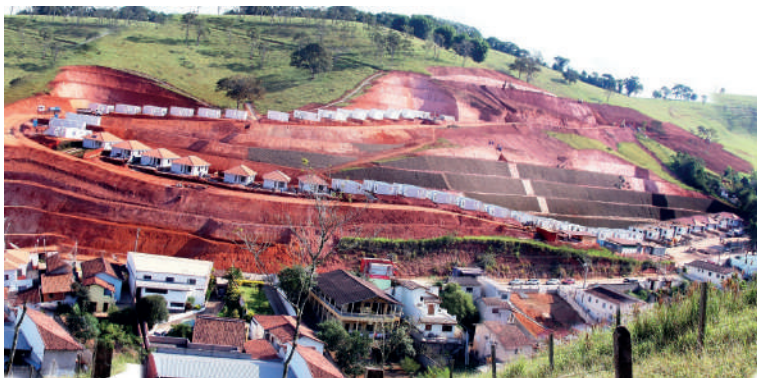
Imagem que mostra o desencontro entre projetos de terraplenagem e os potenciais processos erosivos e de assoreamento que irá provocar (foto de domínio público pelo critério de fair use ).
