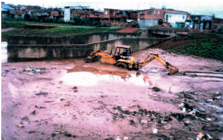
Cena do piscinão do Caaguaçu, na capital paulista, mostrando intenso assoreamento após chuvas intensas (foto de domínio público pelo critério de fair use ).
